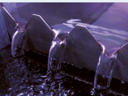
Entkeimung von Wasser mit UV-Licht.
